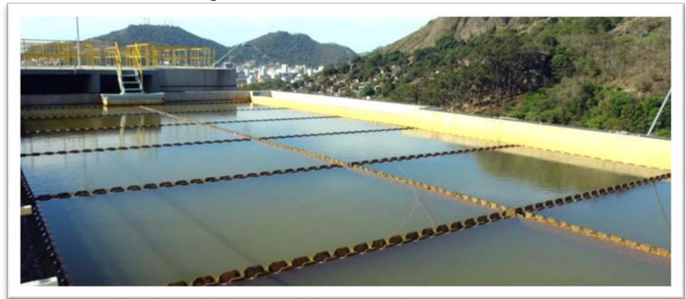
Tratamento da água
